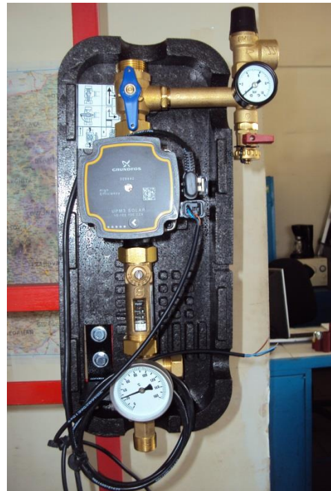
Fig. 7. Panou electropompă de circulație
