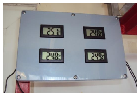
Fig. 8. Sistem de monitorizare a temperaturilor din instalație
