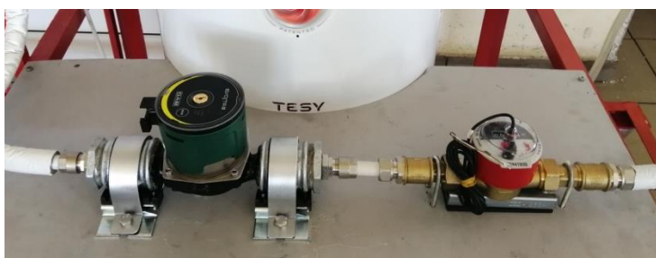
Fig. 5. Electropompă de circulație apă și debitmetru
